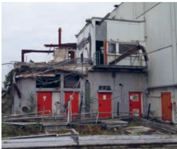
Rückansicht des Hochtanklagers
